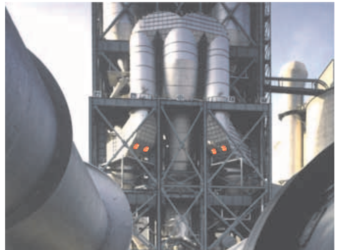
VSR BLASTER® Luftkanonen an einem Zementofen (Foto: Krupp Polysius)
